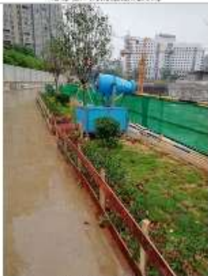
洒水抑尘、雾炮设施
