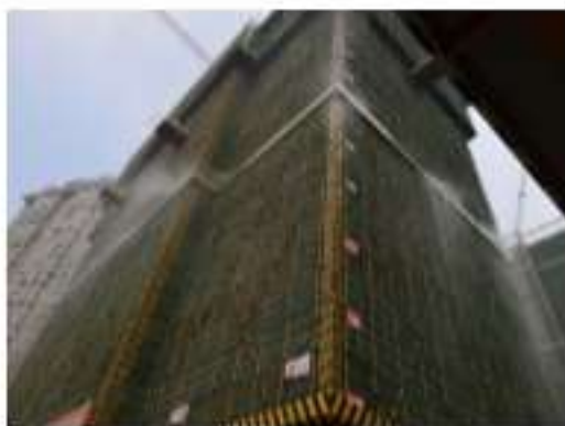
高层建筑施工防尘网及喷雾设施
