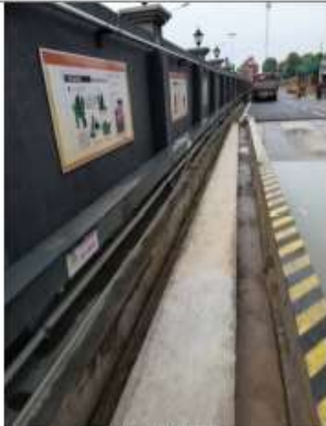
进出口车辆冲洗槽
